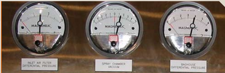
> Panel de control de la secadora por atomización
