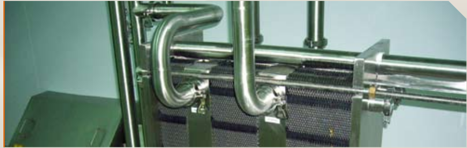
> Intercambiador de calor para enfriamiento
