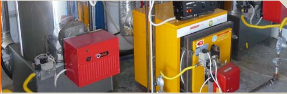
> Caldera de vapor
