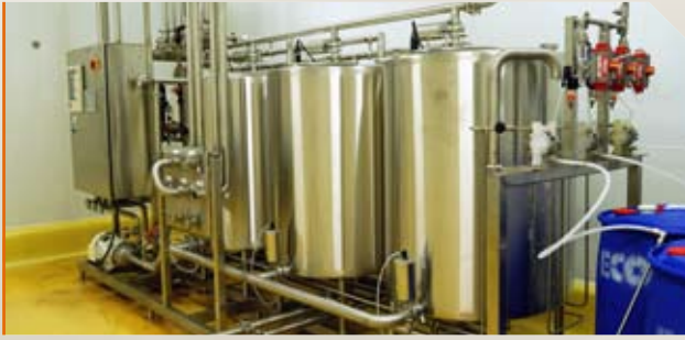
> Sistema de CIP de 3 tanques
